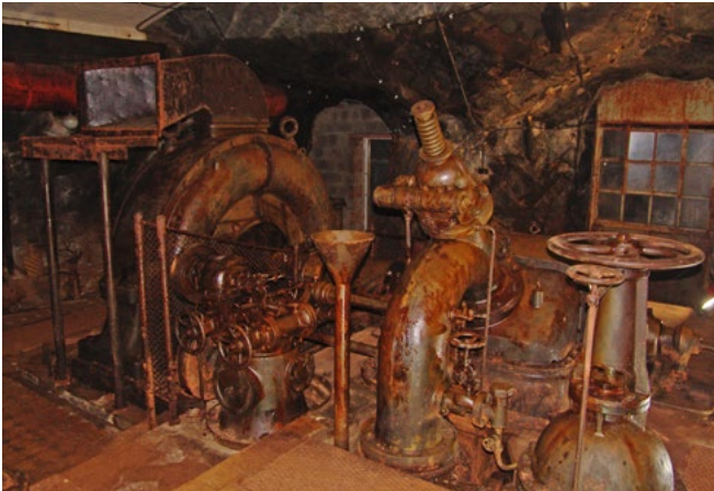
Машинный агрегат I, слева генератор Siemens & Schuckert, 600 кВА, рядом с ним контроллер турбины, справа верхний сопловой узел турбины Peltona, Briegleb & Hansen, 1914 г., состояние 2024 г.
