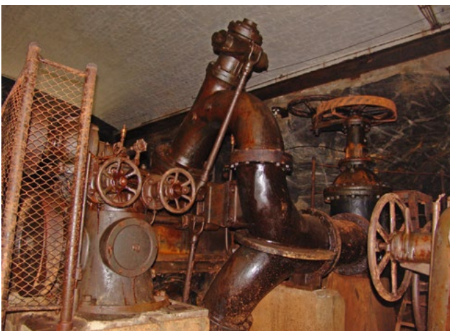
Турбина Peltona, Briegleb & Hansen, 1914 г., впуск, регулятор турбины и верхний сопловой узел, состояние 2024 г.
