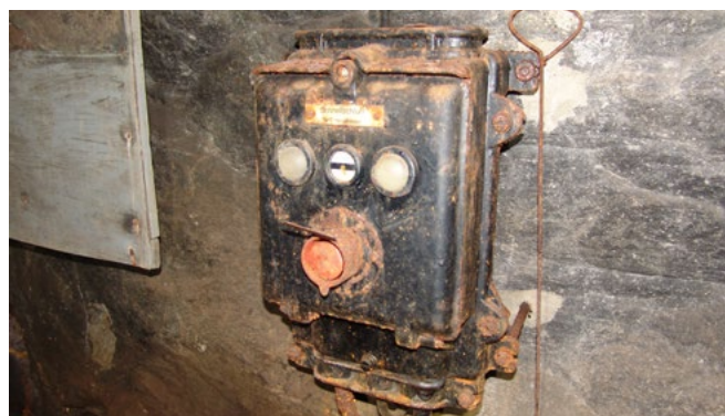
Срабатывание быстрого расцепления (аварийного выключателя), состояние 2024 г.
