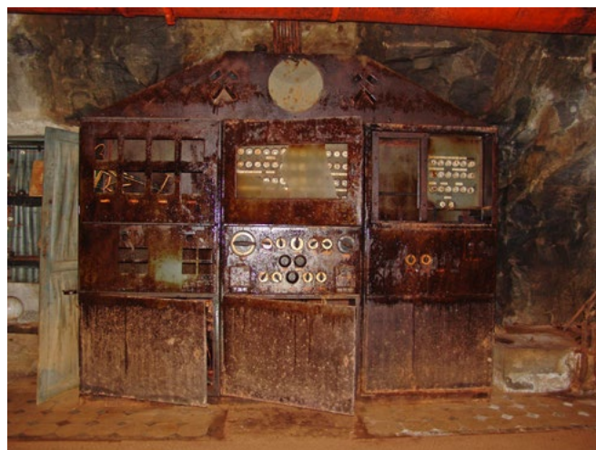
Электрощит пещерной электростанции, состояние 2024 г.
