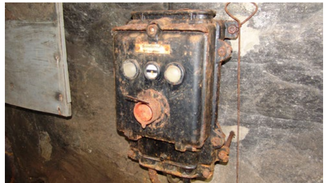
Betätigung des Schnellverschlusses (Notaus-Schalter), Zustand 2024
