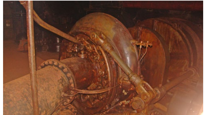
Maschine II, Francis-Spiralturbine, Voith, Blick auf den Leitapparat, Zustand 2024
