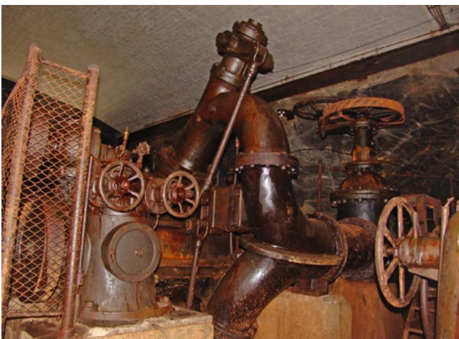
Pelton turbine, Briegleb & Hansen, 1914, Zulauf, Turbinenregler und oberer Düsenstock, Zustand 2024
