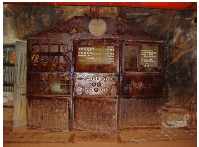
Elektrische Schalttafel im Kavernenkraftwerk, Zustand 2024
