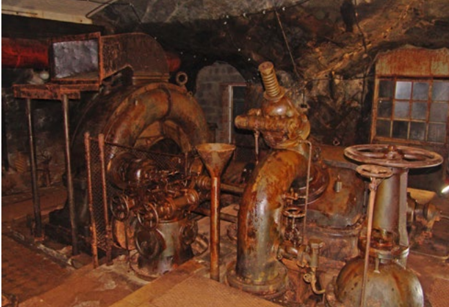
Maschinensatz I, links Generator Siemens & Schuckert, 600 kVA, daneben Turbinenregler, rechts oberer Düsenstock der Pelton turbine, Briegleb & Hansen, 1914, Zustand 2024
